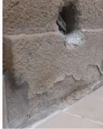
Bas de mur carrelé, joints ciment.
